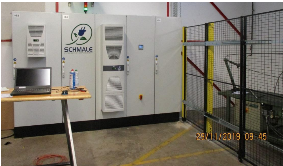
Neuer Schaltschrank und Schutzzaun (Fotoinweis: Schmale Maschinenbau)
