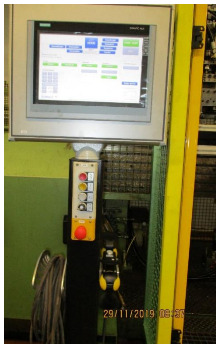
Neues Bedienpanel zur Steuerung
